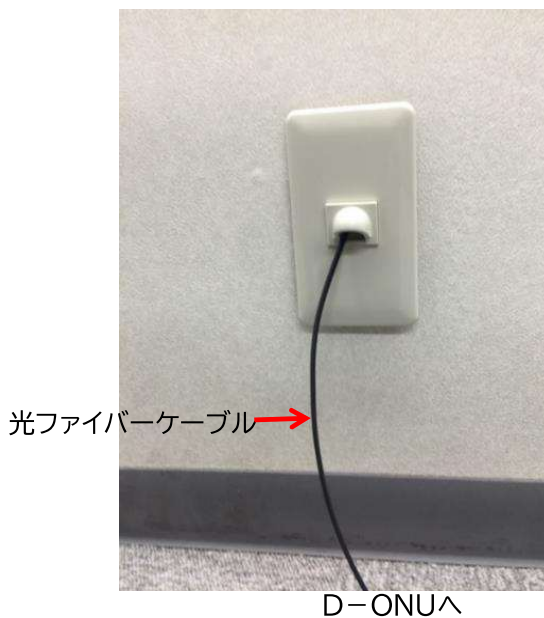
④配管出口(宅内) 光インターネット・光電話
